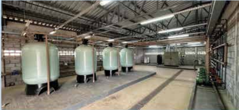
Bateria de filtros – 1ª fase
